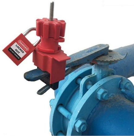
Slika 24. Osiguranje ventila cjevovoda
