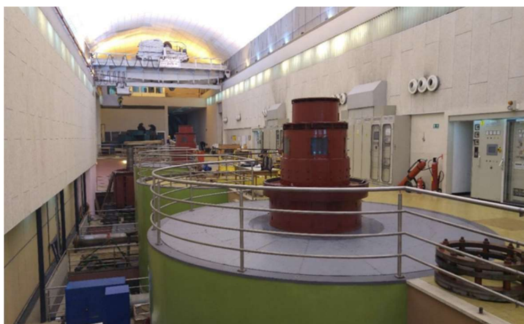
Slika 9. Strojarnica u HE Senj (podzemna)
