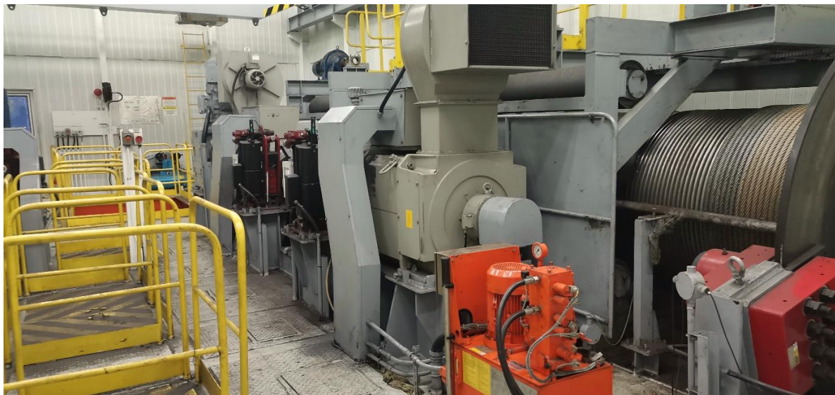
Slika 23. Strojarnica ZPMC Post Panamax dizalice AGCT
