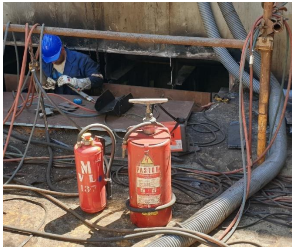
Slika 30. Vatrogasni aparati za PP gašenje požara na mjestu izvođenja toplih radova
