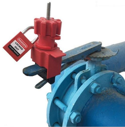
Slika 24. Osiguranje ventila cjevovoda
