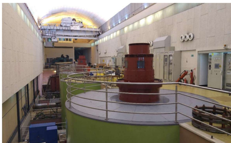
Slika 9. Strojarnica u HE Senj (podzemna)
