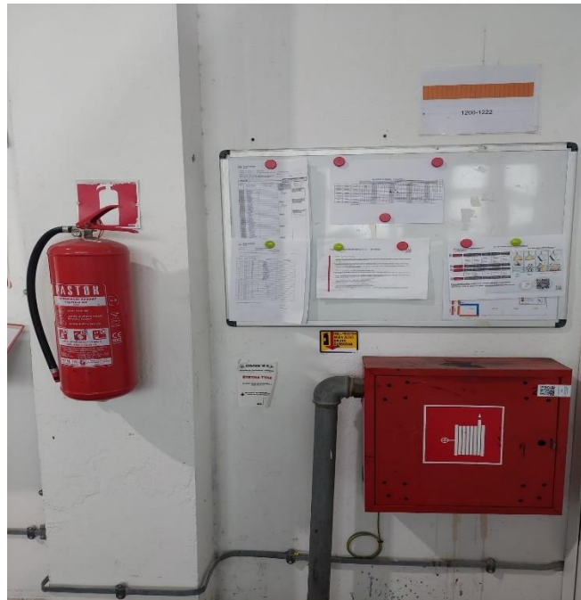
Slika 10: Vatrogasni aparat i unutrašnji hidrant
