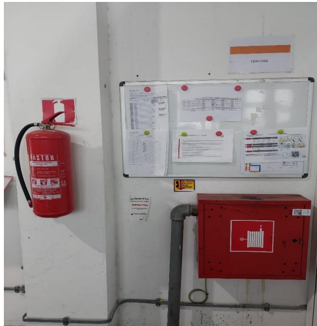
Slika 10: Vatrogasni aparat i unutrašnji hidrant
