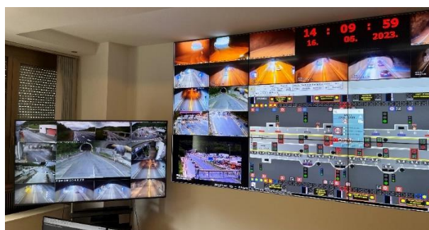
Slika 2. Video zid u Centru upravljanja
