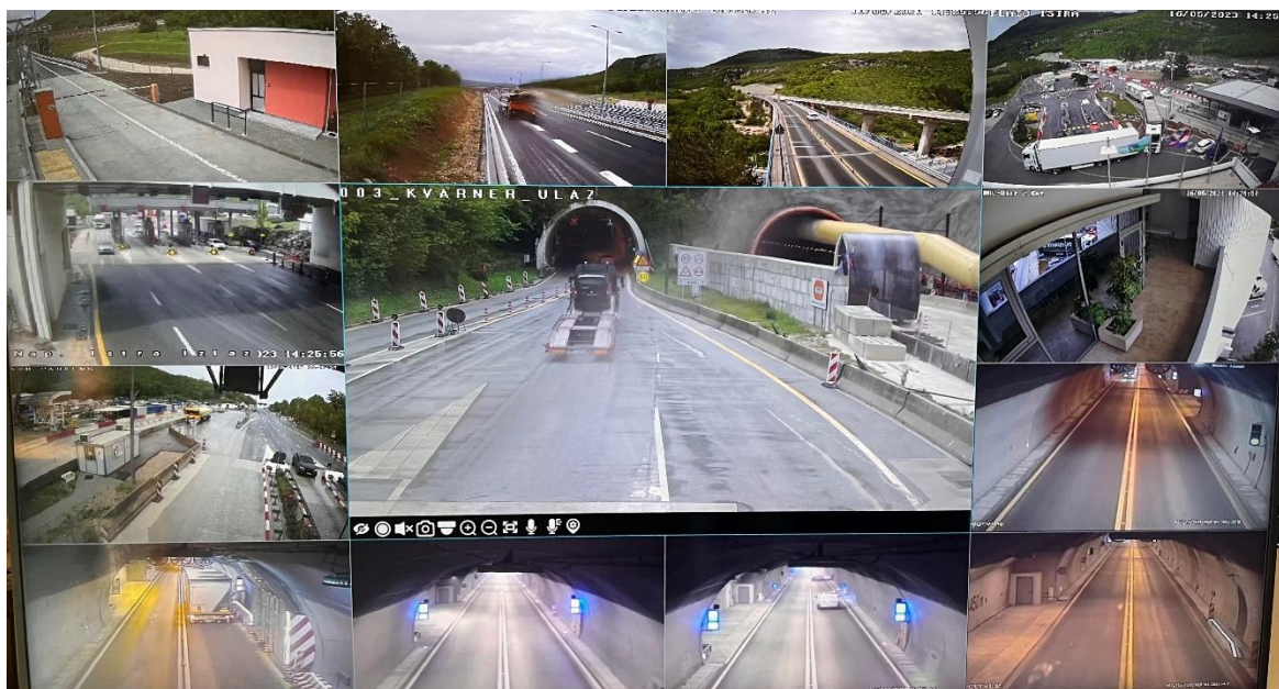
Slika 7. Sustav video nadzora unutar tunela Učka te na ulazu/izlazu iz tunela Učka
