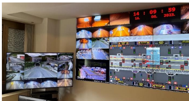
Slika 2. Video zid u Centru upravljanja
