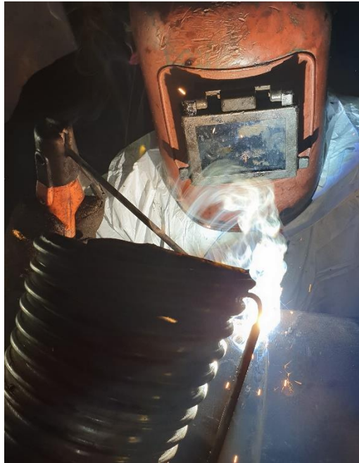
Slika 18. Odgovarajuća odsisna ventilacija prilikom zavarivanja
