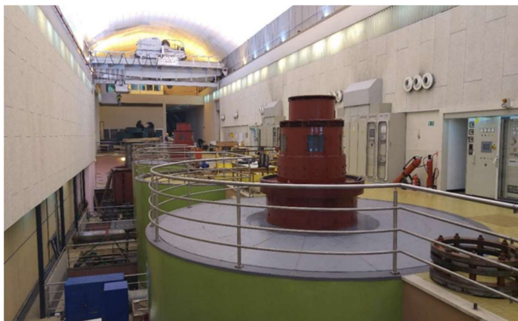
Slika 9. Strojarnica u HE Senj (podzemna)
