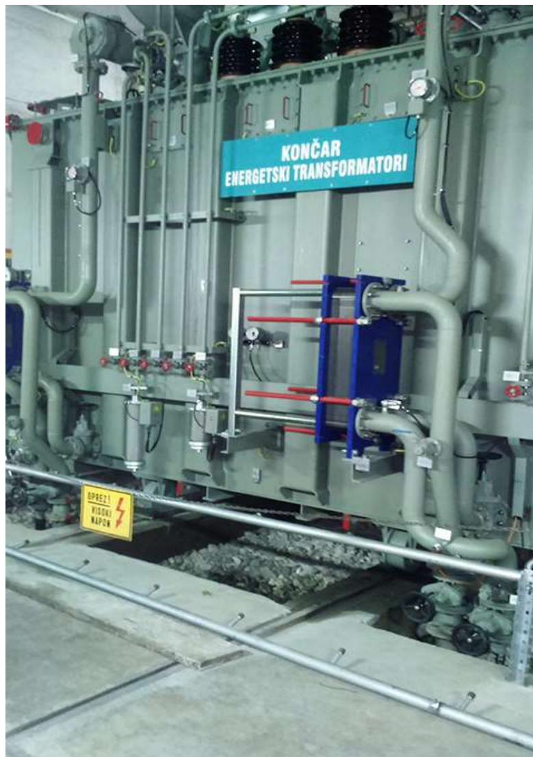
Slika 18. Energetski transformator HE Senj-a
