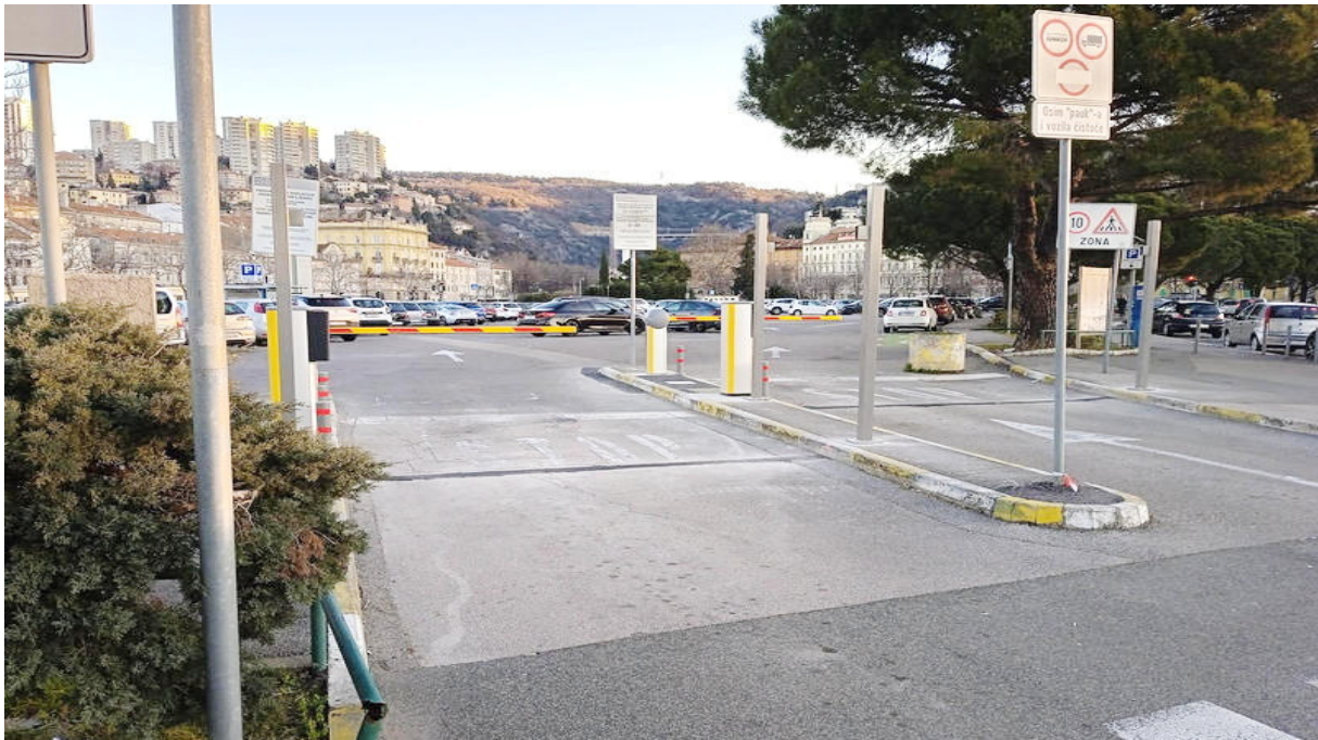
Slika 14. Autonomne motorizirane barijere na ulazu i izlazu parkirališta „Delta“
