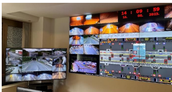
Slika 2. Video zid u Centru upravljanja
