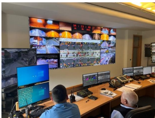
Slika 1. Operativni pult u centru upravljanja
