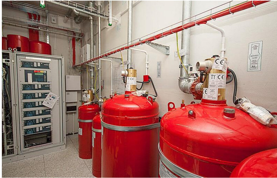
Slika 10. NOVEC 1230 stabilni sustav za gašenje požara
