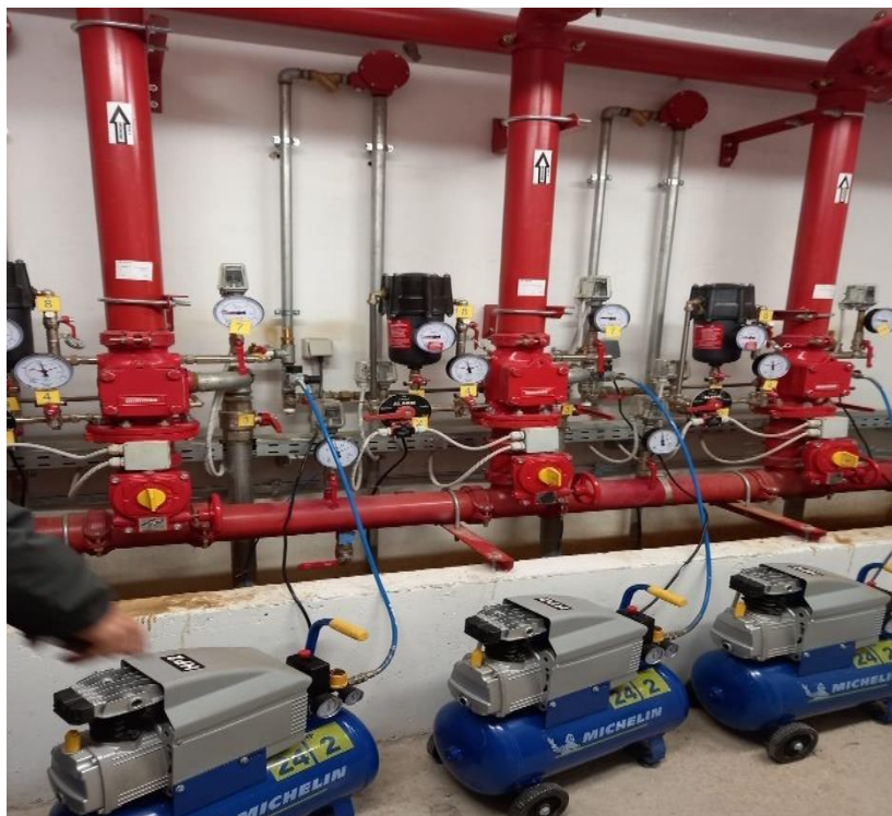
Slika 4. Suhi sprinkler sustav
