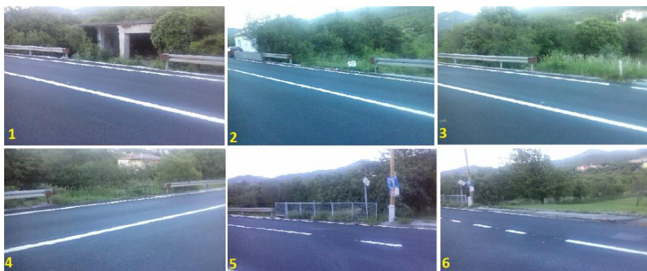
Slika 18. Prekidi u zaštitnoj ogradi
